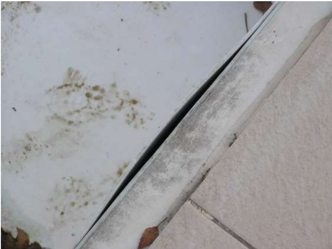
Obrázek 3 – Rozpadající se okraj dětského bazénku – mezera mezi konstrukcí a vanou bazénku
